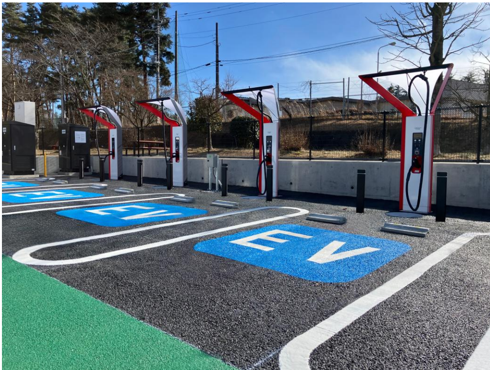
中央自動車道 八ヶ岳パーキングエリア（下り） 急速充電ステーション
